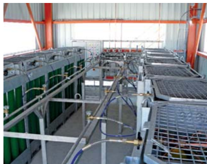
N 2 -Hochdruck-Bündel mit Ventilstation - Lafarge Rezina Cement Plant, Moldavien
