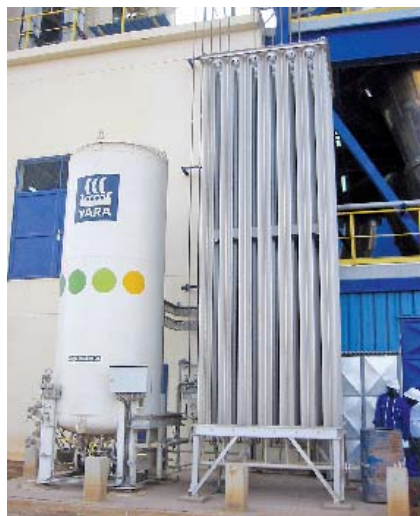
CO 2 -Niederdrucktank mit Verdampfer und Ventilstation - Les Ciments du Sahel, Senegal
