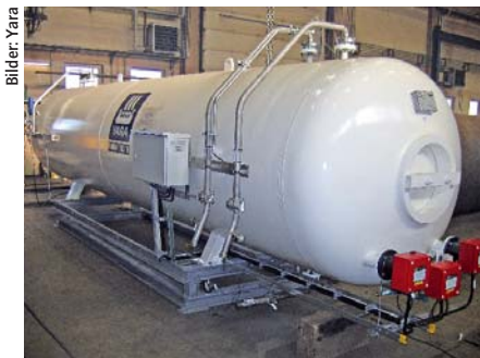
CO 2 -Hochdrucktank – HeidelbergCement, Tula Cement Plant, Russia
