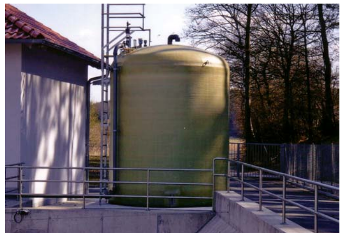
Abb. 2: Lagertank für das Dosierungsmittel
