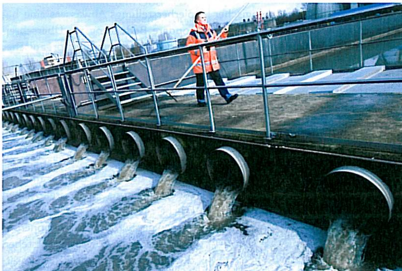
Zulauf des Abwassers in die aerobe Behandlungsstufe einer Kläranlage
