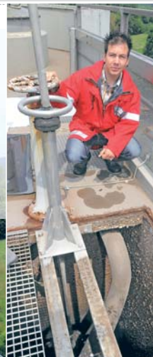
Kläranlagen-Panorama: Thorsten Jung zeigt, was aufsteigender Schwefelwasserstoff anrichten kann. Korrosionsschäden kosten Kaiserslautern viel Geld.
